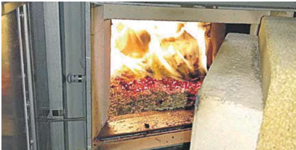
Una caldera a pleno funcionamiento con los 'pellets' de esta biomasa valorizada.
